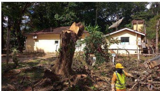
Foto 1 - Colaborador realizando a supressão do indivíduo arbóreo que estava em risco de queda (12/02/2022).
